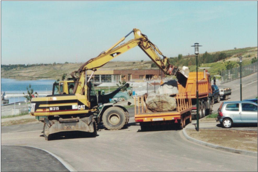
Abb. 25: Geschiebe-Antransport aus dem Tagebau Profen durch die MIBRAG GmbH zur Gestaltung eines Gesteinspfades am Markkleeberger See, 2006. (Foto: H.-J. Bellmann)
